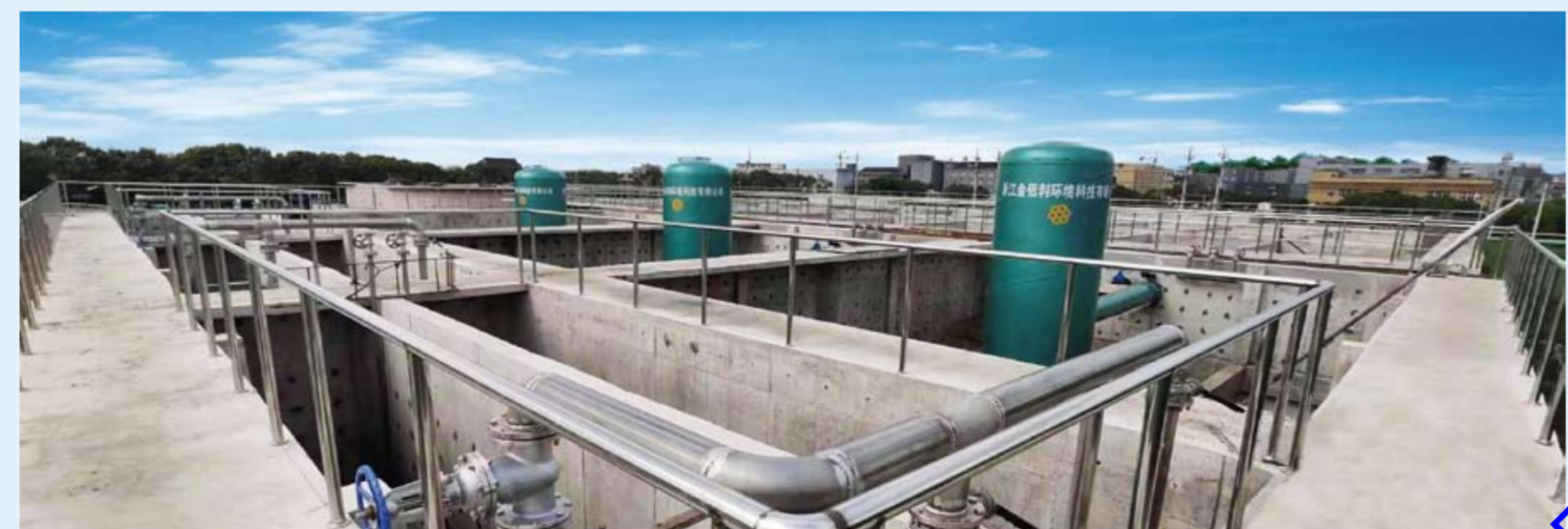
浙江金佰利环境科技有限公司在提高氧转移利用率的基础上降低能耗，有效地解决了传统曝气技术存在的诸多问题。
